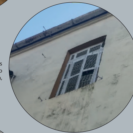
8 - APODRECIMENTO DE ESQUADRIAS Solução: Substituição das partes faltantes e lixamento das que estão em má estado de conservação. Aplicação de inseticida, base protetora e tinta esmalte sintético.
