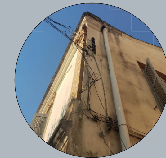
7 - FIAÇÃO ELÉTRICA APARENTE Solução: Concentração da fiação em um único ponto e ocultação dela através de uma eletrocalha.
