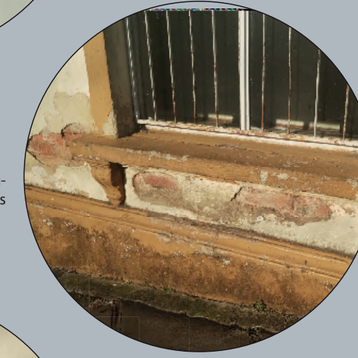
2 - QUEDA DE REBOCO Solução: Remoção do reboco e reprodução dele com os mesmos materiais utilizados.
