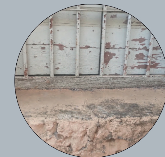
9 - FERRUGEM Solução: Lixamento das partes metálicas da edificação, aplicação de removedor de ferrugem, fundo zarcão e pintura esmalte sintético.
