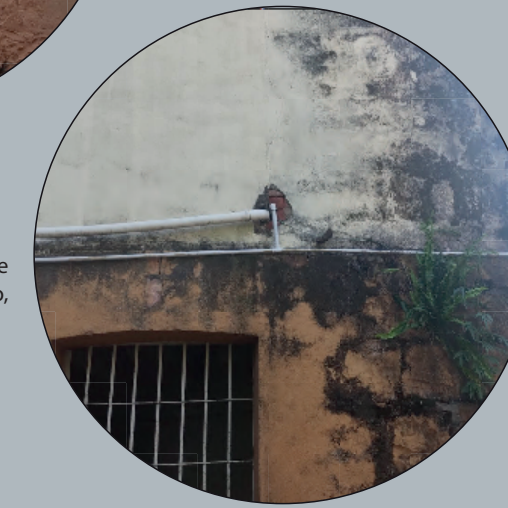
6 - TUBULAÇÃO APARENTE Solução: Remoção das tubulações e criação de paredes duplas na edificação, com tubulação oculta.
